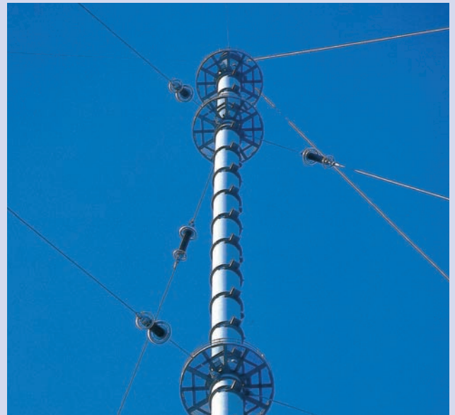
▲傘型アンテナ頂部
