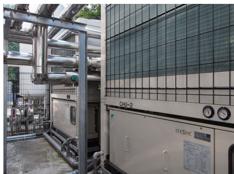
省エネ運転している ミリ波棟の冷温水同時取り出しチラー
