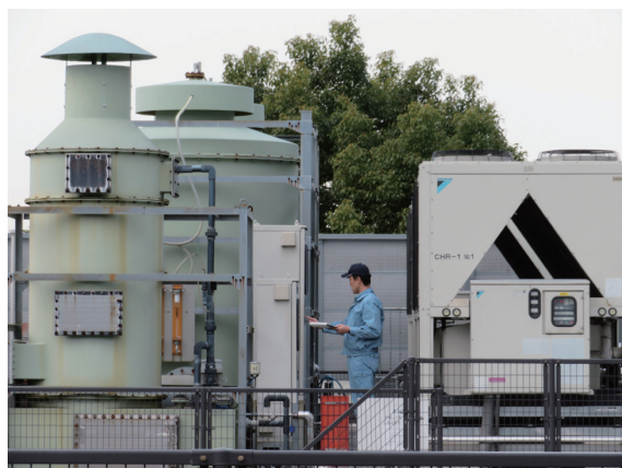
PDL の空調設備
