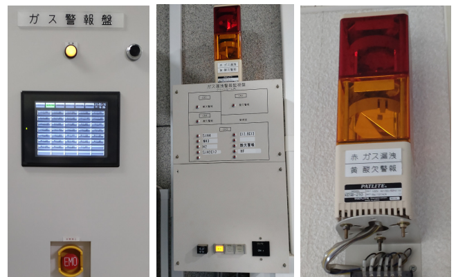
(b) 集中警報盤 (c) ガス漏洩通報装置 (d) パトライト
