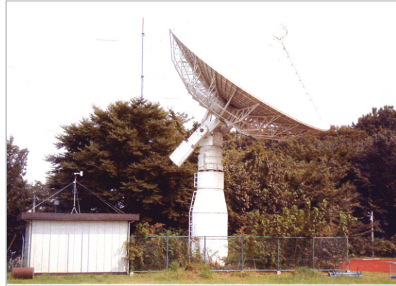
図4 11mパラボラアンテナ外観
