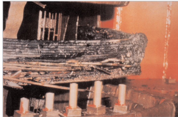
図3 宇宙天気により焼損した電力トランス内部のコイル
