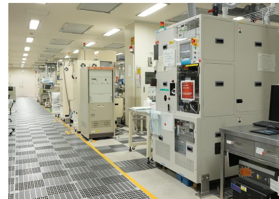
先端ICTデバイス研究開発推進センターの クリーンルーム
