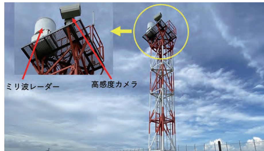
図 羽田空港に設置されている90 GHz帯レーダーの実証試験機
