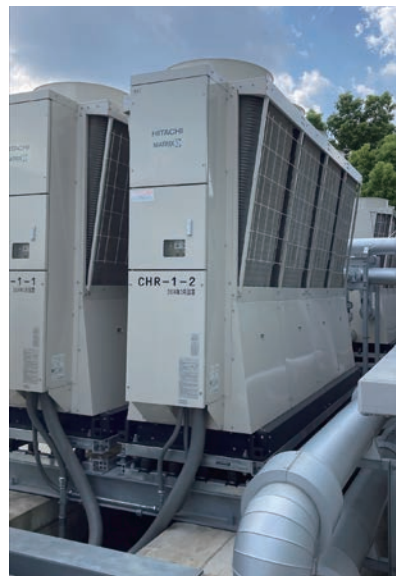
PDL の空調設備
