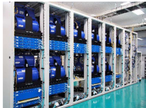
図 5：超高速光伝送実証設備
