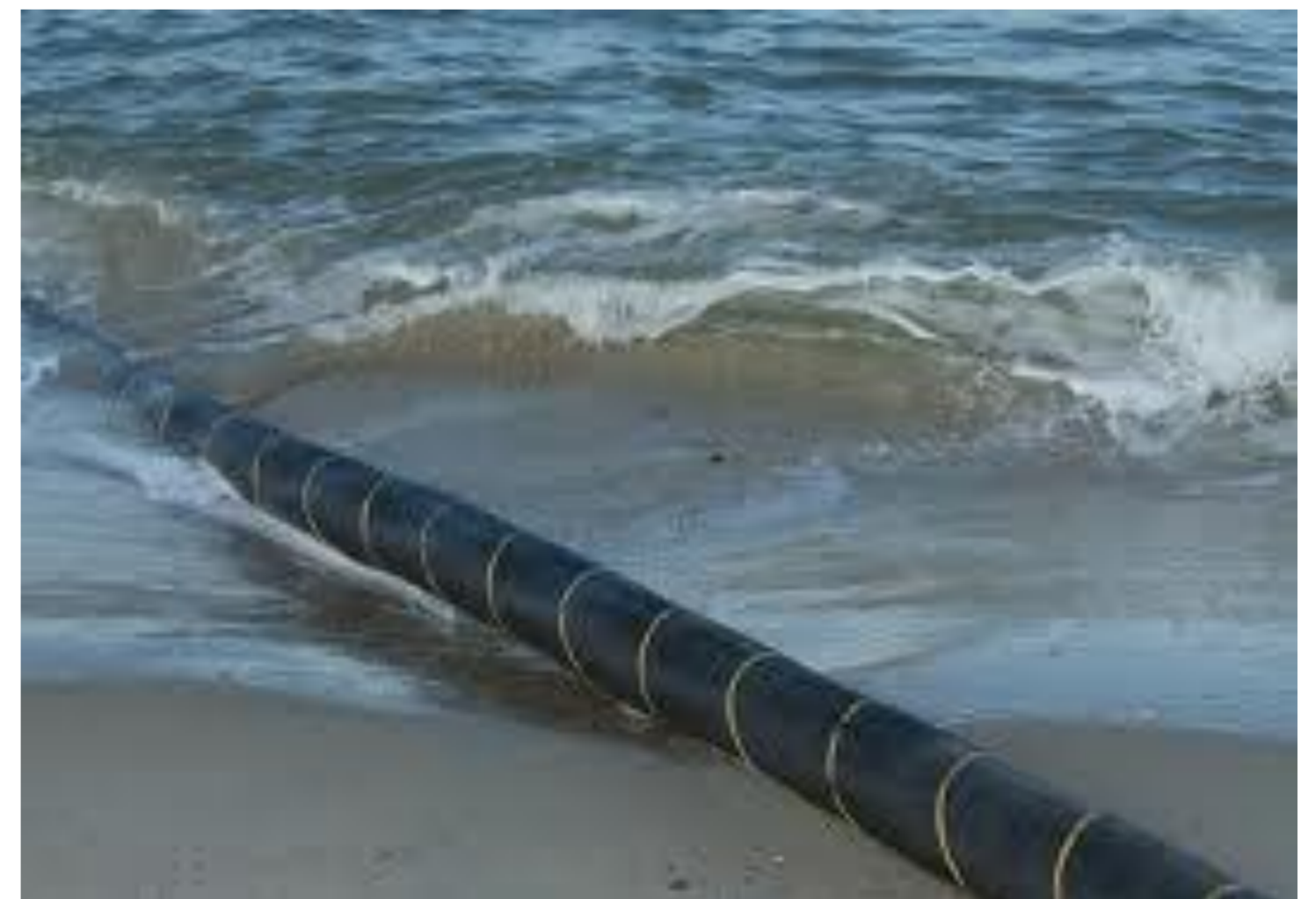
陸上幹線系・大陸間海底ケーブルの大容量化
