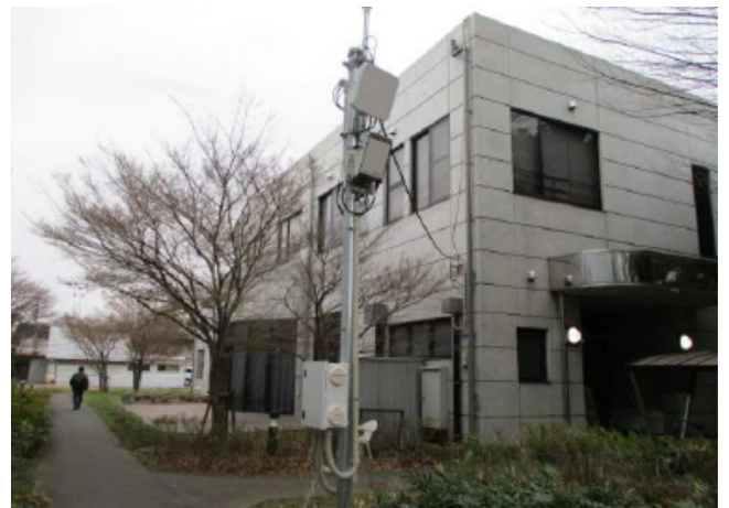
図6 B5G モバイル環境の基地局外観
