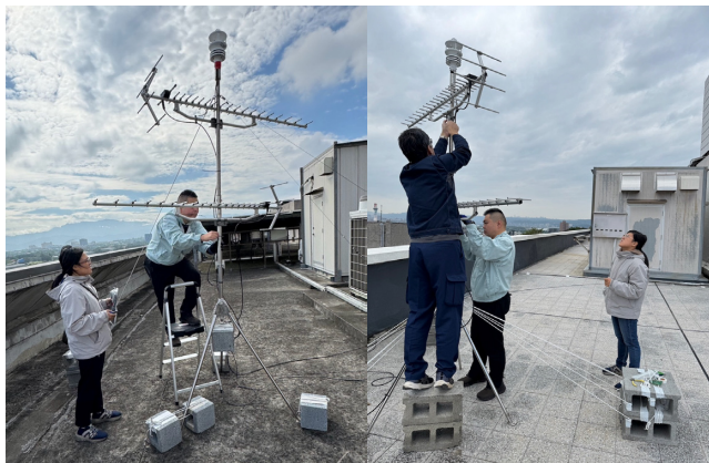
図9 NTUB, NYCUでの水蒸気量観測装置用アンテナおよび地上気象観測装置の設置風景 (左: 国立臺北商業大學桃園キャンパス (NTUB)、右: 国立陽明交通大學 (NYCU))
