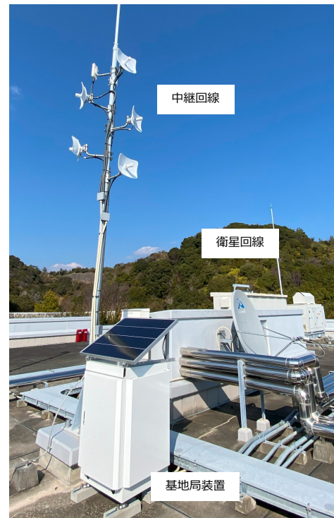
図3 白浜町での基地局設置例(消防本部屋上)
