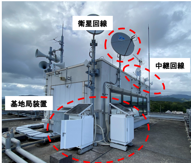
図10 延岡市での基地局設置例（延岡市役所屋上）
