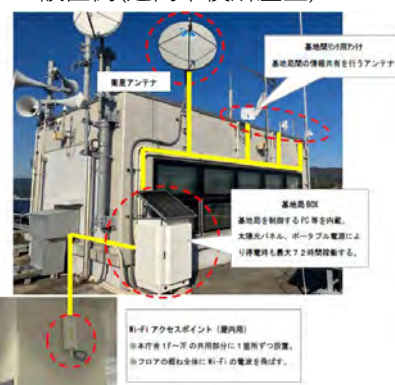
設置例(延岡市役所屋上)
