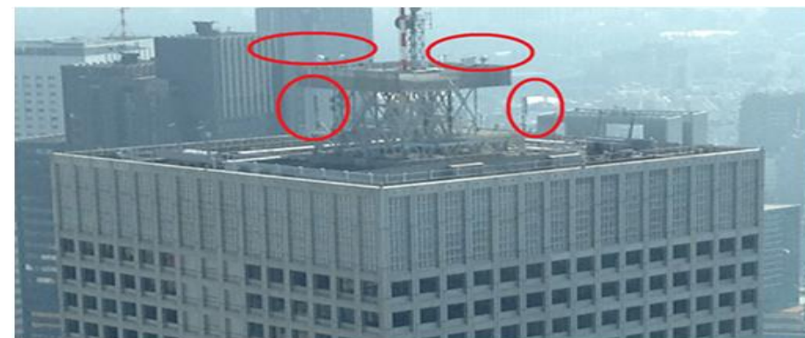
KDDI新宿ビル設置の災害用大ゾーン基地局 アンテナおよび無線回線設備
