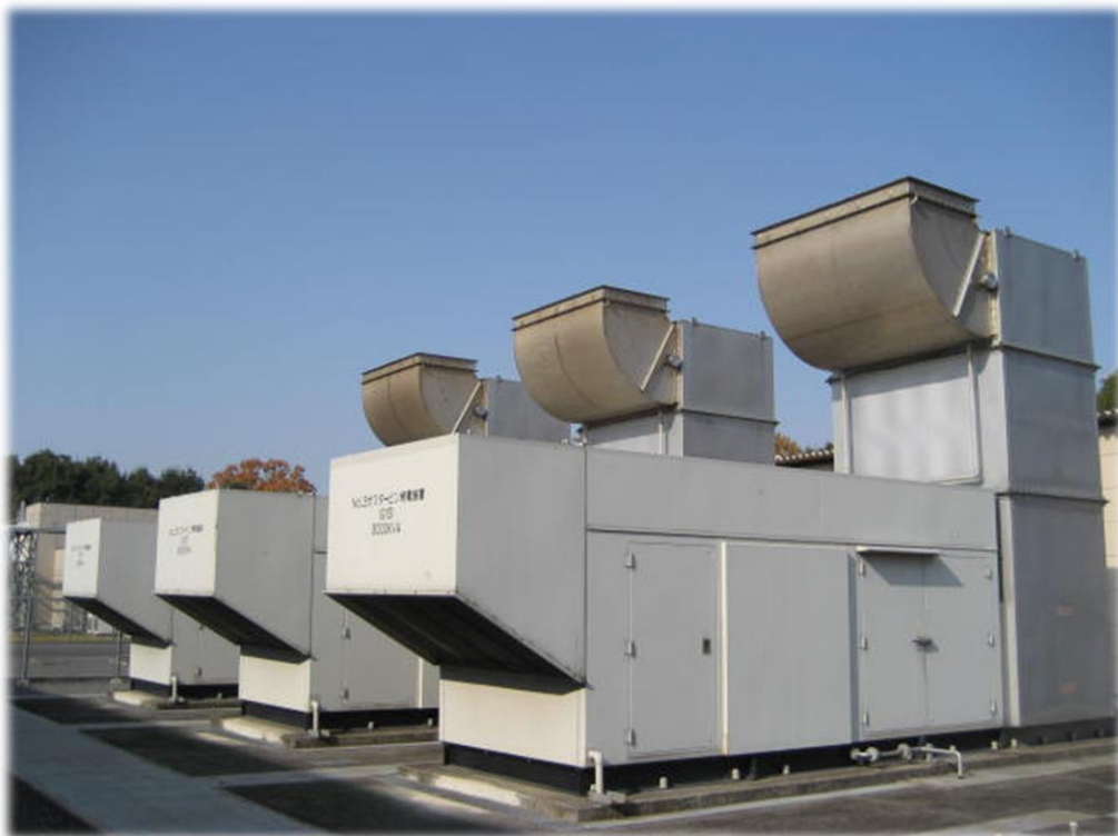
非常用発電機 (停電1分以内で給電可能)
