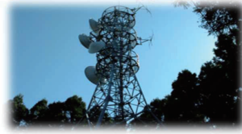
防災行政無線設備の被災
